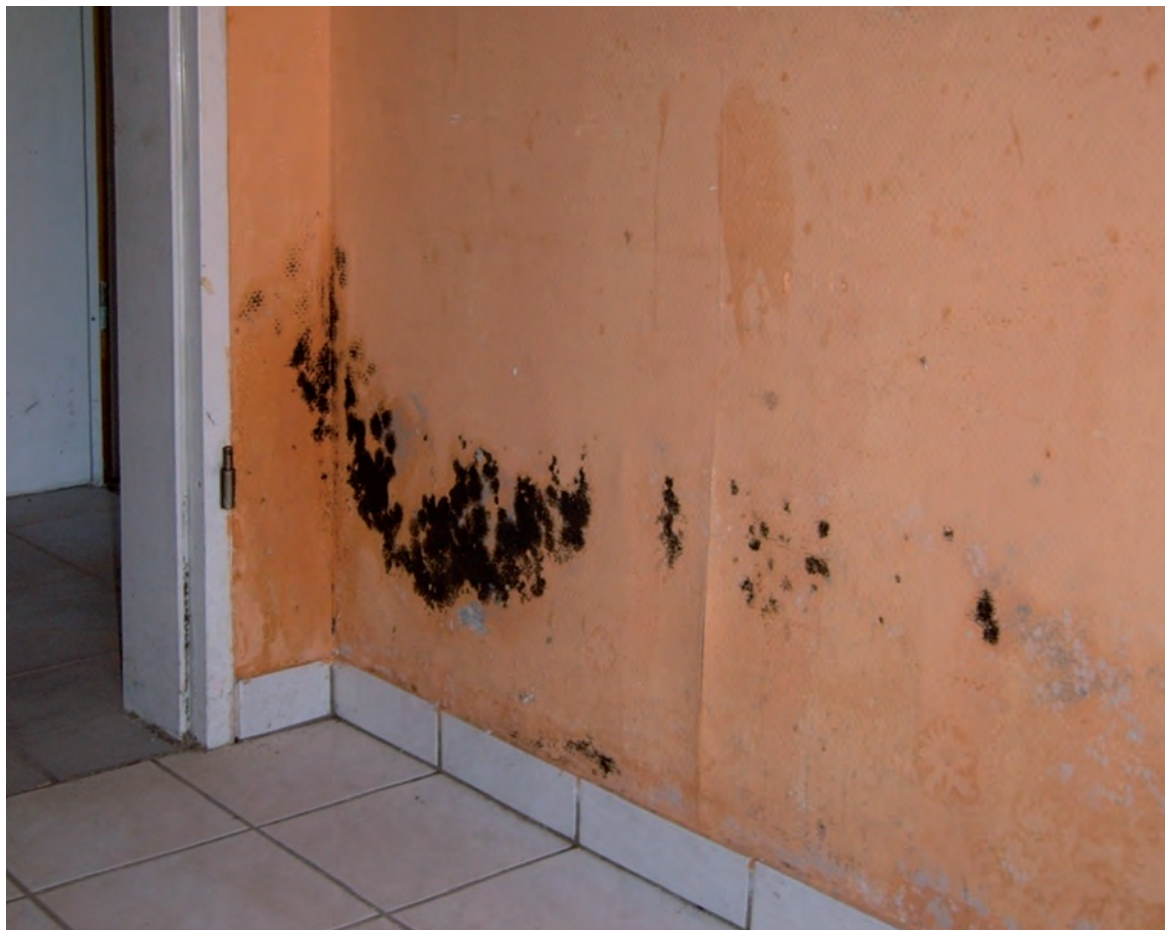
Schimmel gefährdet nicht nur die Bausubstanz, sondern auch die Gesundheit der Hausbewohner.
