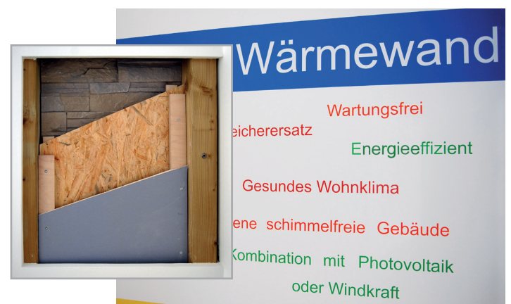
Von außen ist sie nicht von einer normalen Wand zu unterscheiden – doch das Innere der Wärmewand (o.l.) hat es in sich
